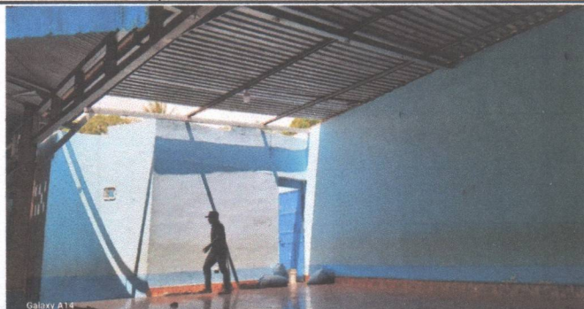
Foto 1: CAMBIO DE ESTRUCTURA METALICA Y LAMINAS POR FISURAS Y GRIETAS, ADEMAS DE OXIDACION Y CORROSION.
